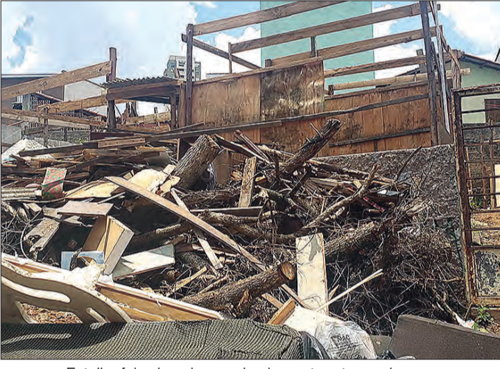
Entulho foi colocado na calçada e estava tomando a rua
