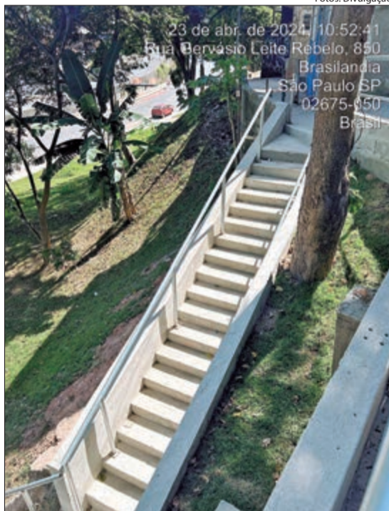
Só no Jardim Peri, são mais de 10 escadões em toda a região, e a maioria recebeu reparos da Siurb (Secretaria Municipal de Infraestrutura Urbana e Obras)
